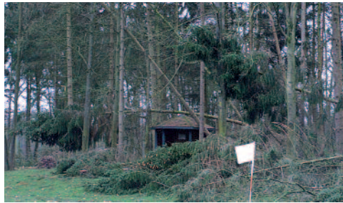
Ein wüstes Bild gab der Wald neben Bahn 14 ab. Die Schutzhütte dort wurde von den umgestürzten Bäumen begraben.
